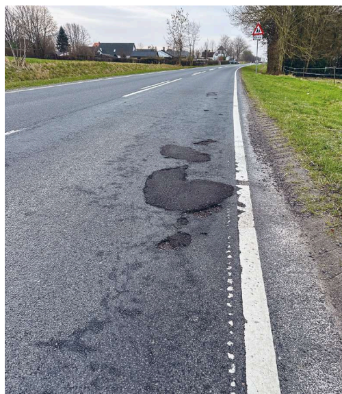
Figur 1: Frostskadet vej med nødtørftige lapper.
